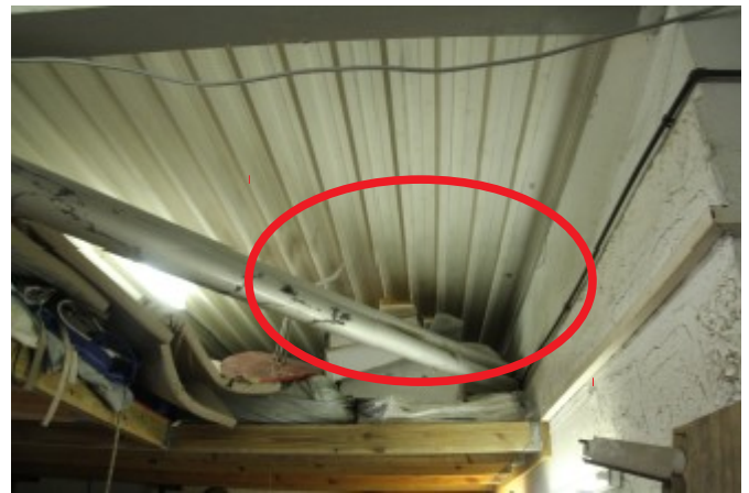
Bac acier avec traces de corrosion
