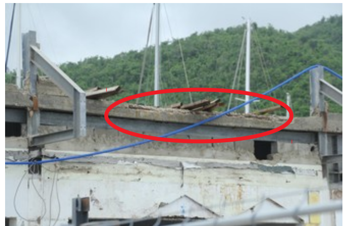
Détail de corrosion de la structure
