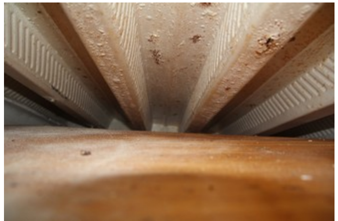
Bac acier avec légères traces de corrosion
