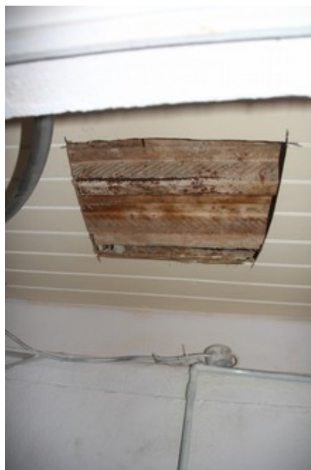
Sous face corrodée
