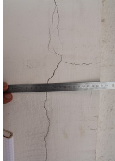
Détail de fissure
